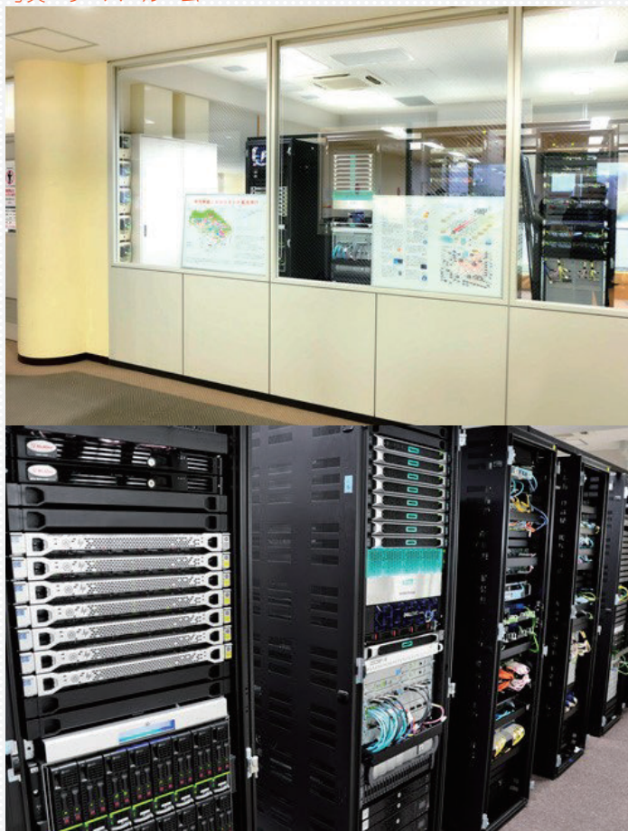
写真：サーバールーム
